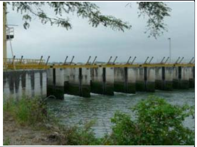
Compuertas de la presa Simbocal
